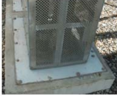
第 3-2-3 図 受変電設備のパンチング部分 (小動物対策)
