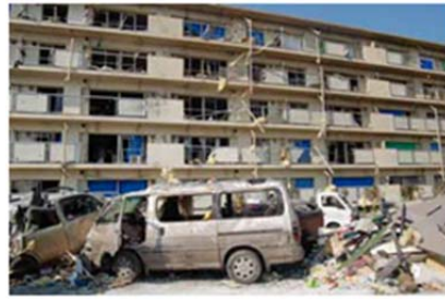
飛来物により被害を受けた住宅等
