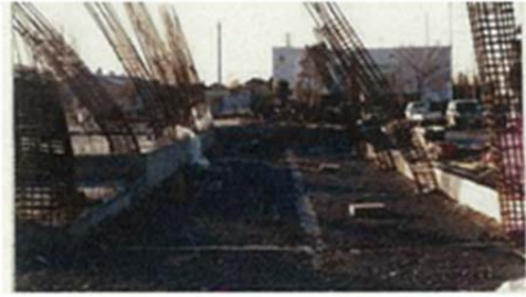
曲がった鉄筋（工事現場）
