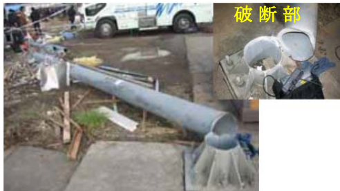
倒壊した道路標識支柱
