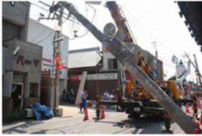
倒れた電柱(復旧作業時)
