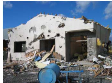
飛来物による被害を受けた建物
