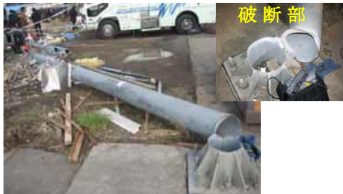
倒壊した道路標識支柱
