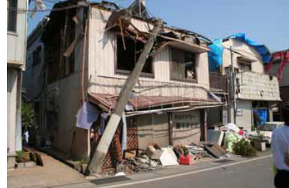
倒壊電柱に直撃された家屋
