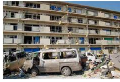
飛来物により被害を受けた住宅等
