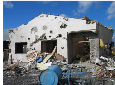
飛来物による被害を受けた建物
