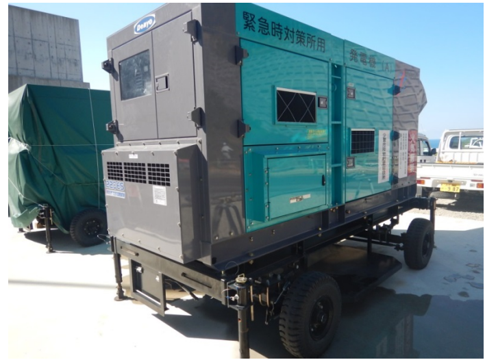
緊急時対策所用発電機
