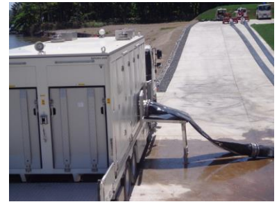
可搬型建屋外ホース接続 (300A)
