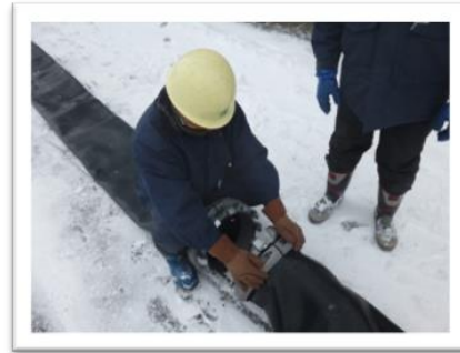
建屋外ホース接続 (300A)
