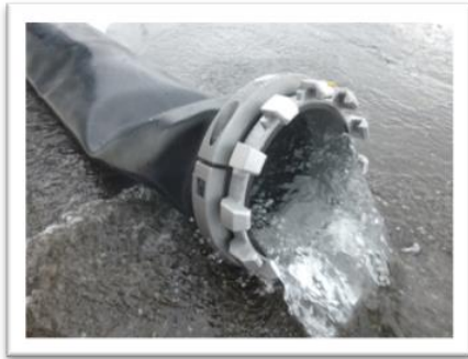
建屋外ホース接続箇所 (300A)
