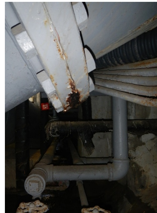
二次冷却系配管 止水後
