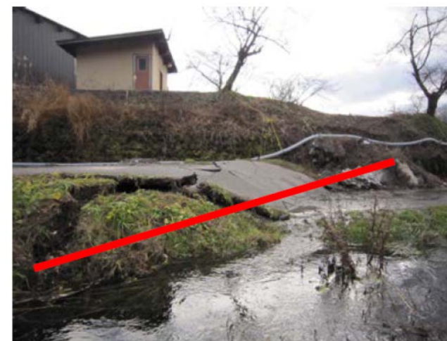
城山地区における地表地震断層 (断層を実線で記載)
