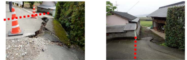
写真30 地表地震断層による道路の破壊(左)と非常に古い木造住宅(右:左の建物が対象,右の新しい倉庫は無被害,D3,撤去確認)
