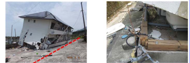
写真42 地表地震断層と3階建ての古い木造アパート(左:東南面,右:北東隅角部の柱脚部の拡大図,金物が無く,地震動で南面1階の駐車開口部が崩壊し,南向きに転倒,D5,撤去確認)
