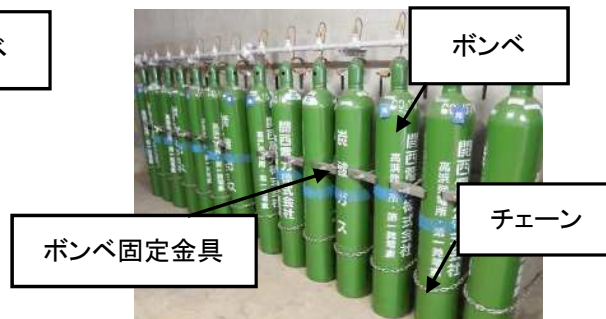
高浜2号炉 CO 2 H 2 ポンベ室 液化炭酸ガス (発電機用)
