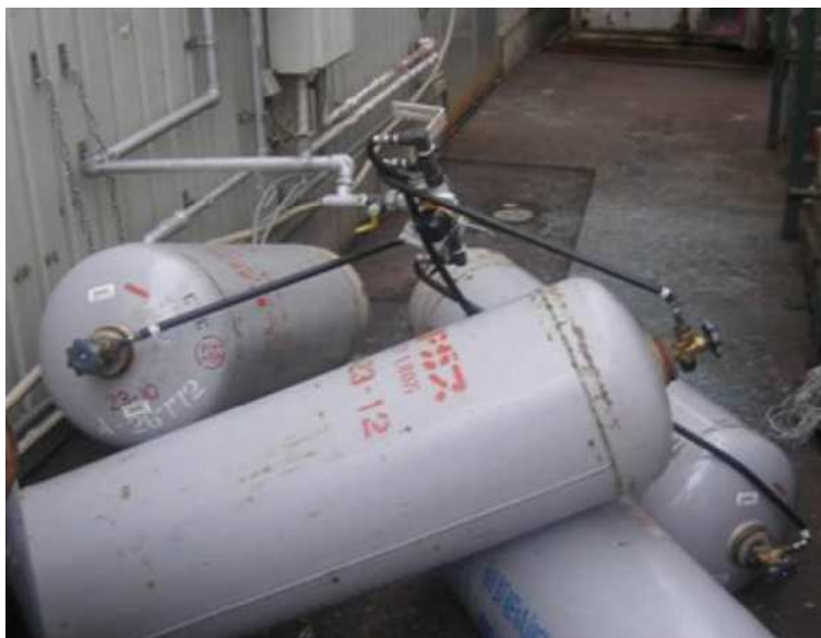
東日本大震災での LP ガスポンベの被災状況の一例 3)
