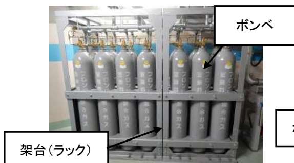
高浜3号炉 外周建屋 ハロン 1301 (消火設備)
