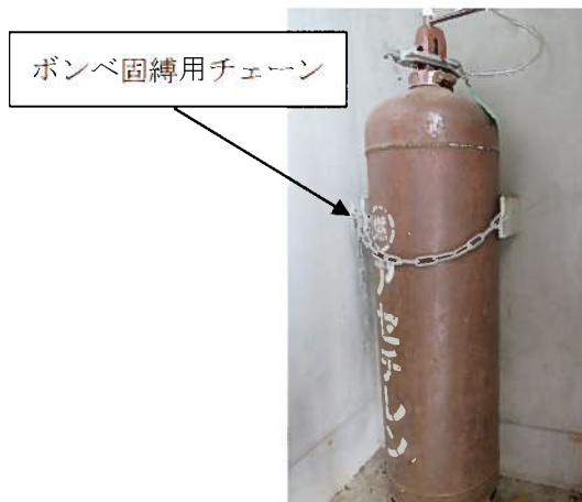
アセチレン (ガスボンベ室)
