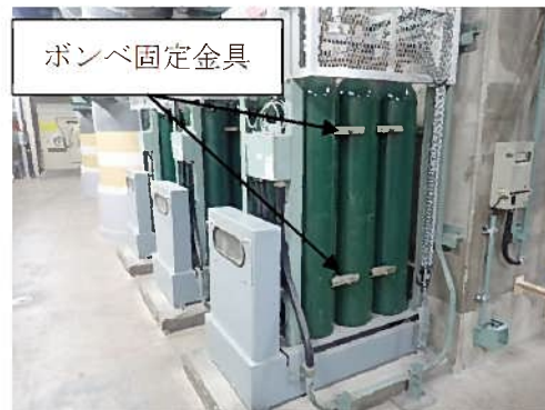
液化炭酸ガス (1号 DG 建屋)
