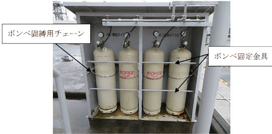
図 LPガスボンベ保管状況（補助ボイラ起動用）
