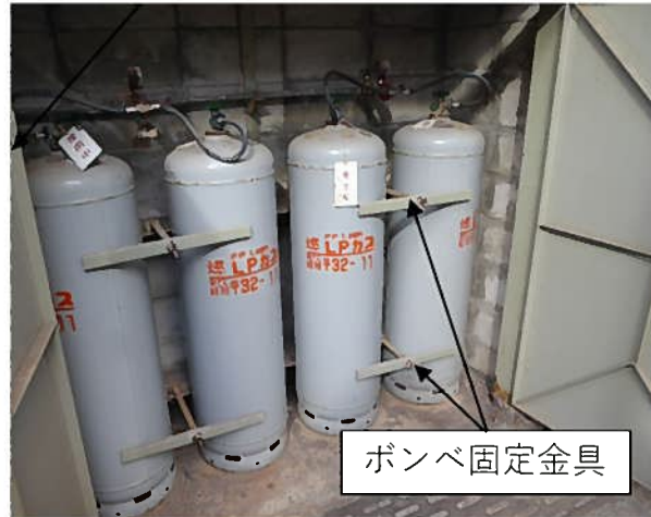
図 LPガスボンベ保管状況（1,2号補助ボイラ起動用）
