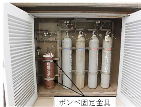
アセチレン (タービン建屋)
