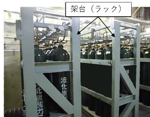
液化炭酸ガス (3号原子炉周辺建屋)
