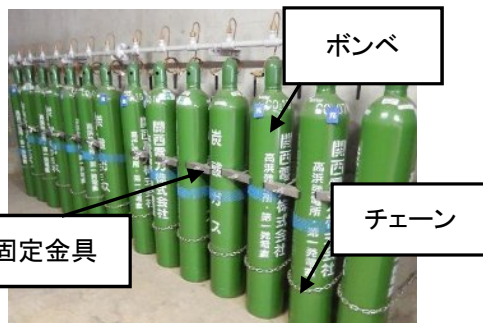
高浜2号炉 CO 2 H 2 ボンベ室 液化炭酸ガス (発電機用)
