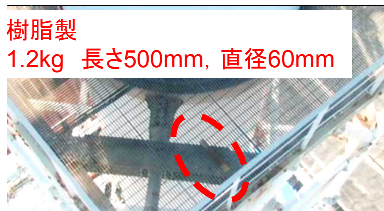
写真：挿入ガイド（バー部）落下箇所
