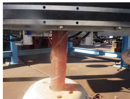
写真：落下防止ワイヤー
