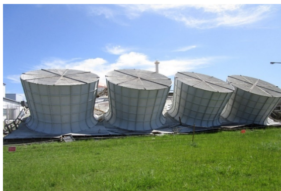
冷却塔倒壊後 西側
