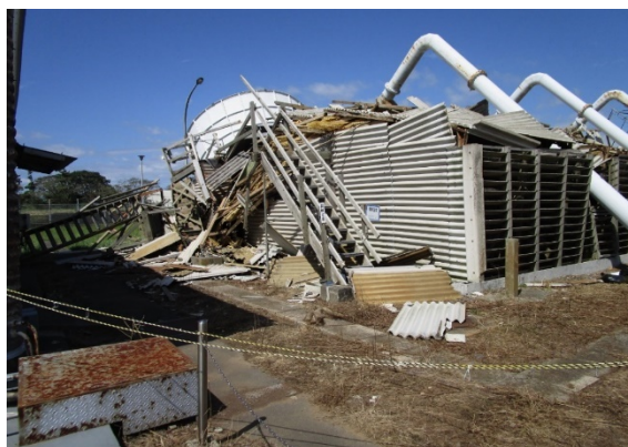
冷却塔倒壊後 南側
