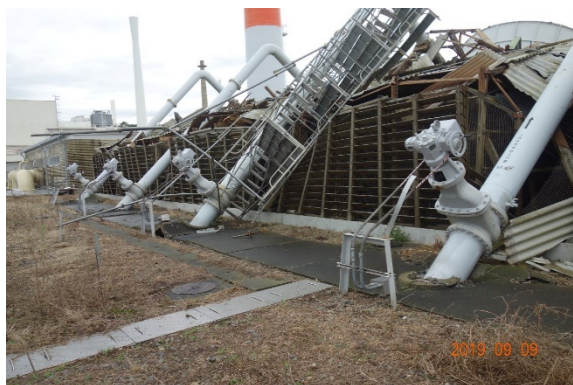
冷却塔倒壊後 東側
