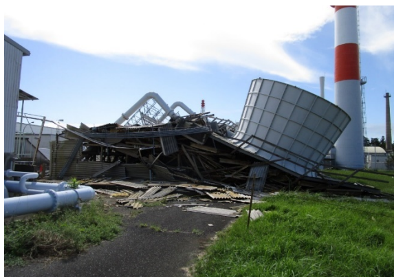
冷却塔倒壊後 北側
