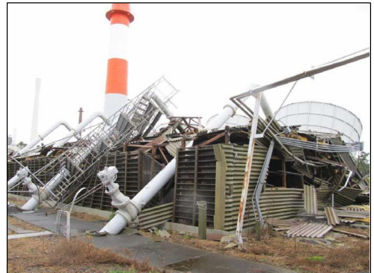
冷却塔倒壊後(R1.9.9撮影)
