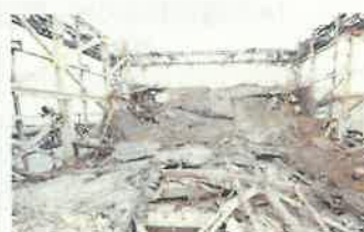
建屋上部のガレキの状況
