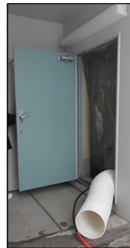
排気ガス用ダクト設置例
