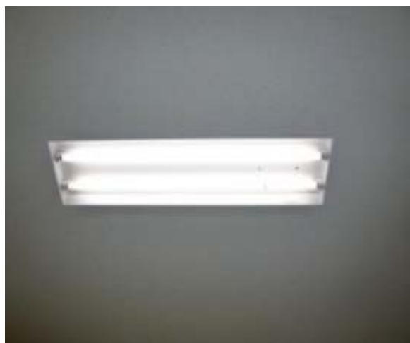
運転保安灯（作業用）
