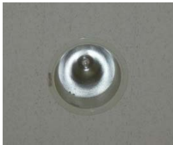
直流非常灯（作業用）
