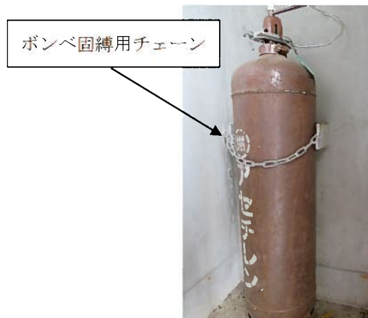
アセチレン (ガスポンベ室)
