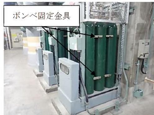
液化炭酸ガス (1号 DG 建屋)
