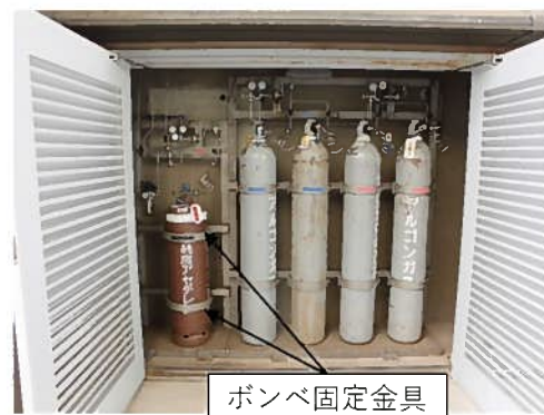
アセチレン (タービン建屋)
