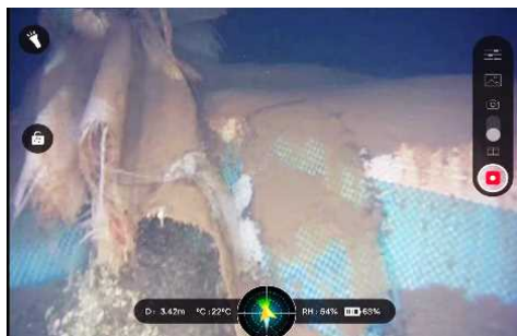
破損している土嚢
