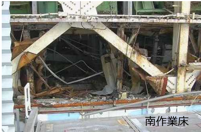
スキマーサージタンクハッチ
