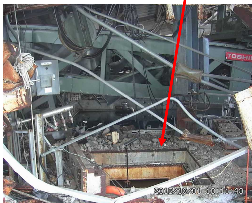
南西スキマーサージタンクハッチ周辺ガレキ
