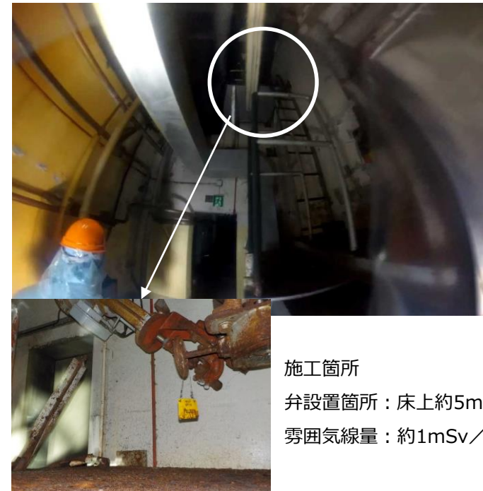
原子炉キャビティ差圧調整ライン状況 2
