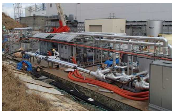
プラント設備
