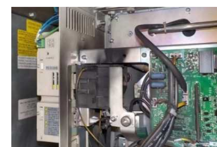
主巻インバータ内部の煤 (5月11日)
