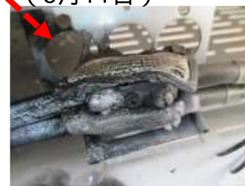
ブレーキレジスタ内の損傷 (5月12日)
