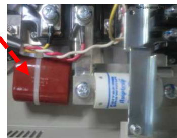
損傷の確認されたヒューズ (4月25日)
