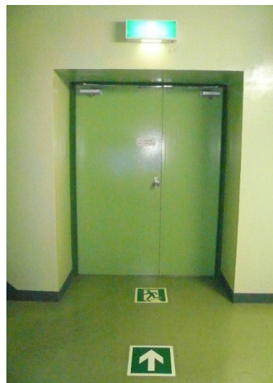
避難口誘導灯
