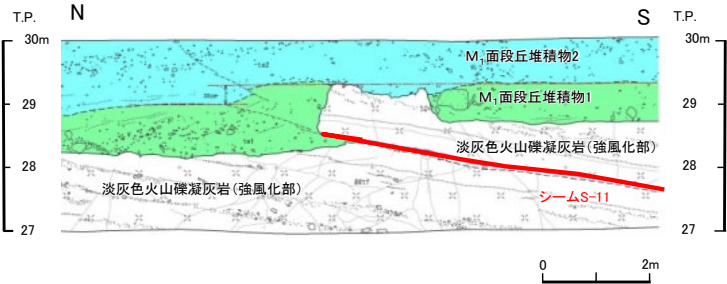
Ts-7トレンチ東側法面: 変状が認められる (見掛けの鉛直変位量約30cm[段丘堆積物中の層理面の段差]) (P.4-20参照)
