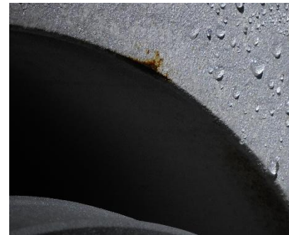
図 2-5 2015 年度 No. 4-33 通風管変色部
