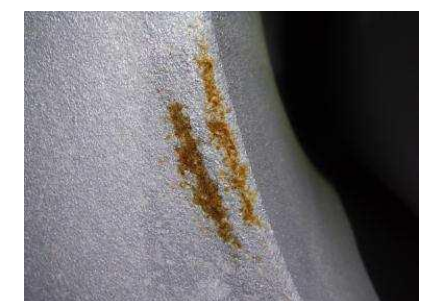
図2-2 2015年度 No. 3-65 通風管変色部2
