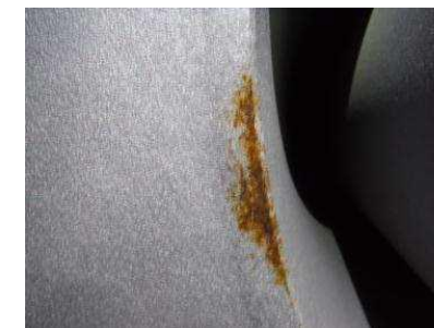
図2-1 2015年度 No. 3-65 通風管変色部1
