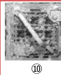
吊り上げ不可
