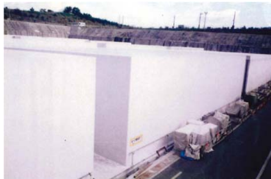
写真4 表面被覆状況(1号4-C)
