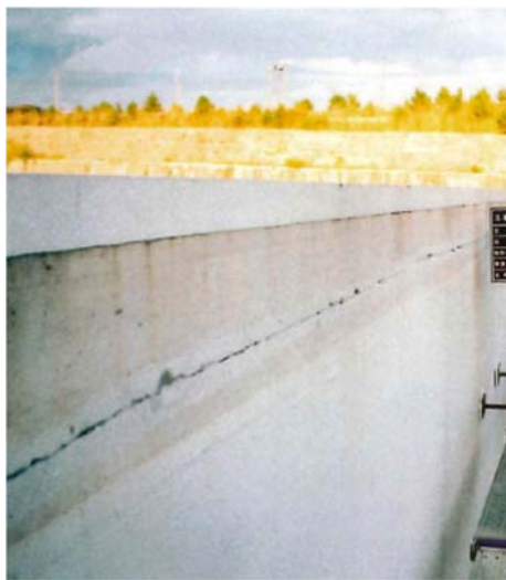
写真1 覆い側部のひび割れ状況
