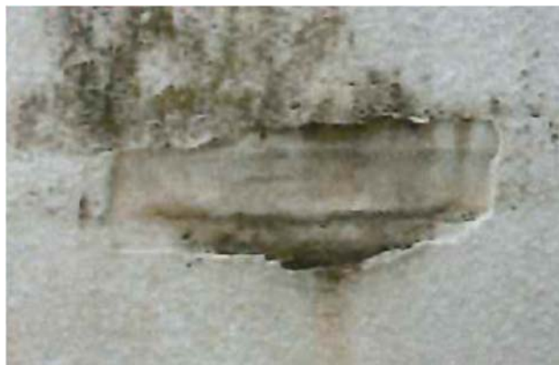
写真 10 表面被覆の剥離(1号 4-C 覆い側部)
