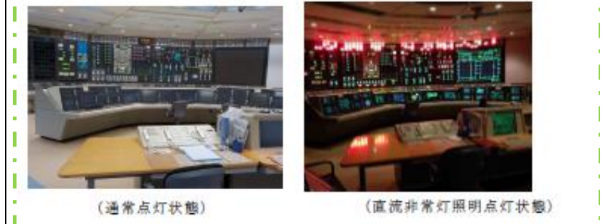
図 2.5-5 非常灯照明下で中央制御室の状況
