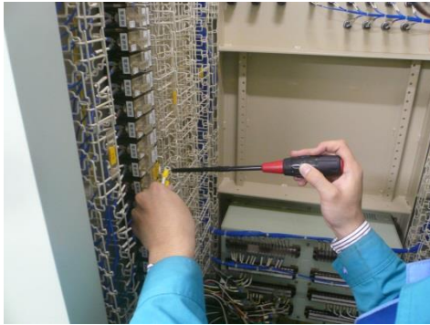
自動減圧継電器盤へ接続
