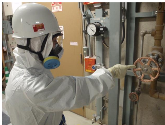
逃がし安全弁用窒素ガスボンベ（待機側）のインサービス
