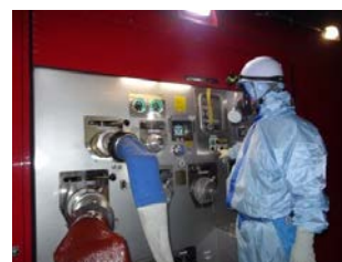
ポンプ起動操作（夜間）
