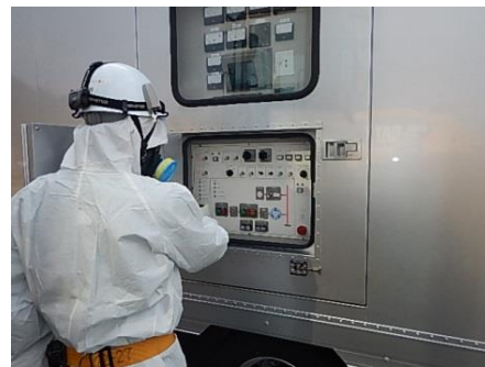
高圧発電機車での作業
