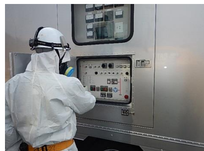
高圧発電機車での作業
