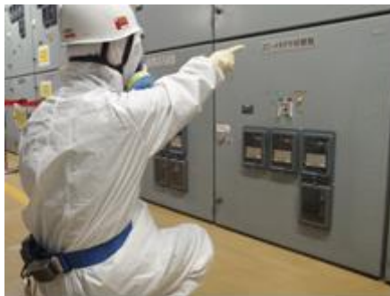
遮断器手動投入
