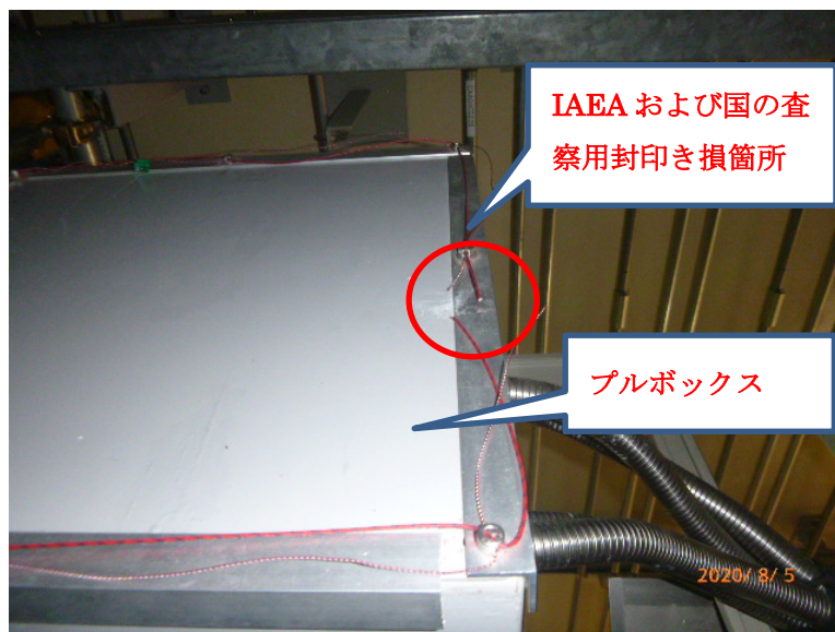
写真-1 プルボックスに取り付けられた査察用封印のき損状況
