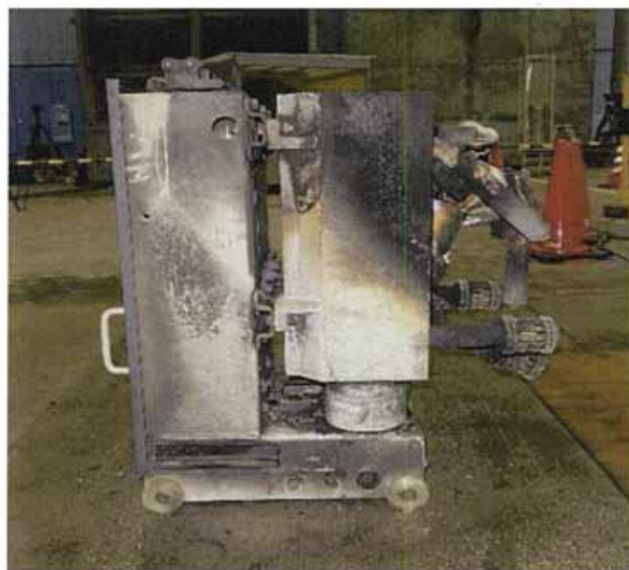
遮断器室アーク発生、アーク火災有、消火後の遮断器の様子
