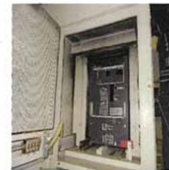
試験後の盤正面の状態
