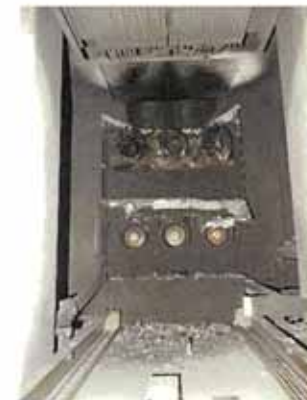
盤内開口部の状態(遮断器室)
