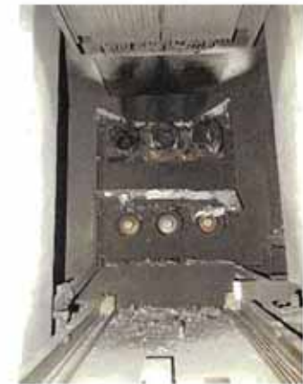
盤内開口部の状態(遮断器室)
