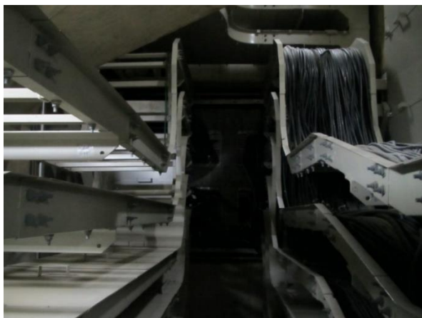
図3① ケーブルダクト室内 MCT 付近
