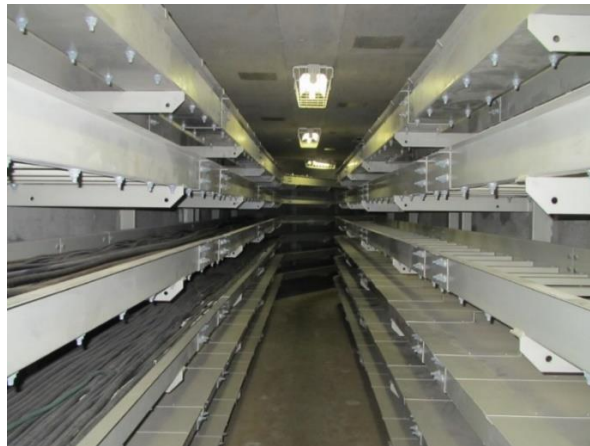
図3② ケーブルダクト室内
