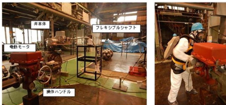
ベント操作（遠隔手動弁操作機構）
