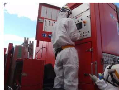
ポンプ起動操作
