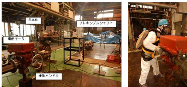
ベント操作（遠隔手動弁操作機構）
