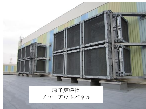
原子炉建物ブローアウトパネル
