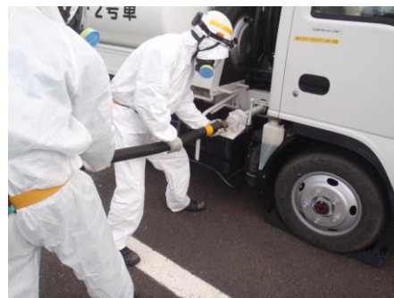
タンクローリへのホース接続
