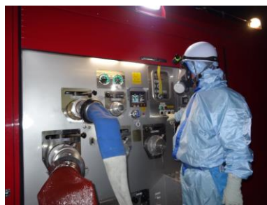
ポンプ起動操作（夜間）
