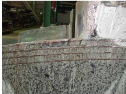
引張縁破断状況
