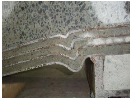
圧縮縁はらみ出し状況
