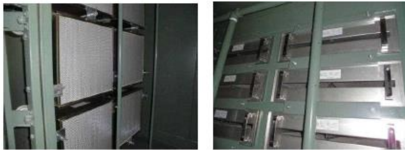
(高性能フィルタの取付け状態) (活性炭フィルタの取付け状態)
