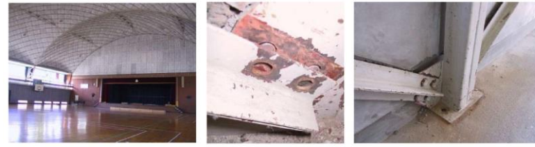
内観 筋かい材ボルト破断 間柱脚部アンカーボルト破断
