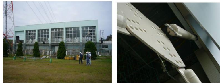
外観 筋かい材プレート破断
