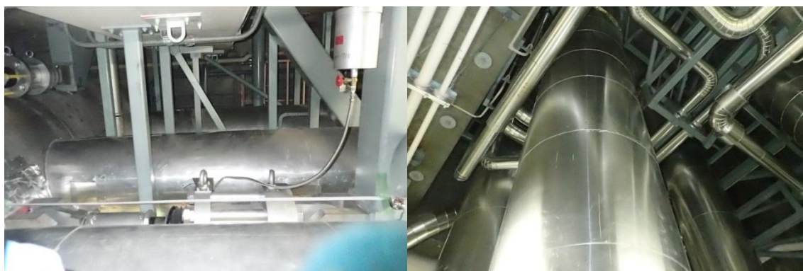
(a) 主蒸気ヘッダ周辺 (600A) (b) 高圧タービン下部 (1050A)
