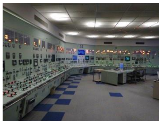
（直流非常灯点灯状態）
