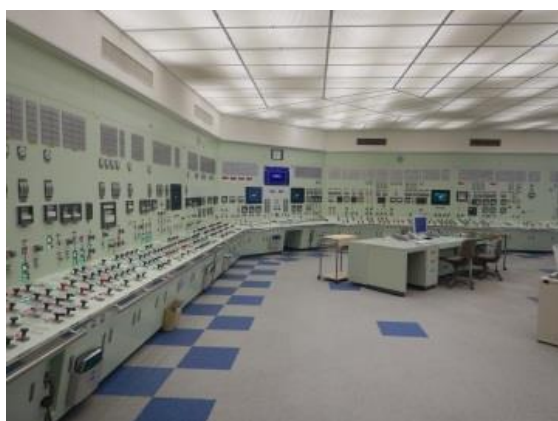
（通常点灯状態）
