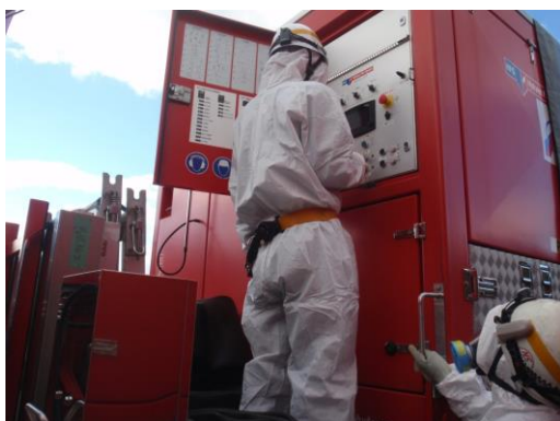
ポンプ起動操作
