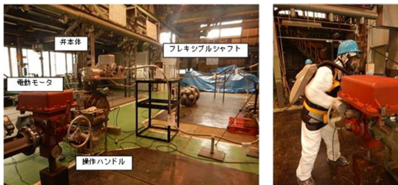
ベント操作（遠隔手動弁操作機構）
