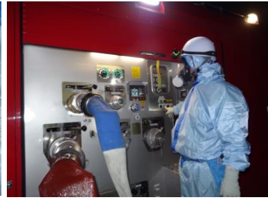
ポンプ起動操作（夜間）
