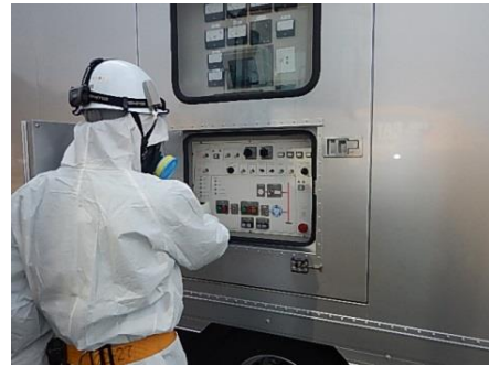
高圧発電機車での作業
