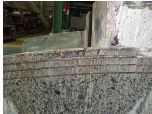
引張縁破断状況
