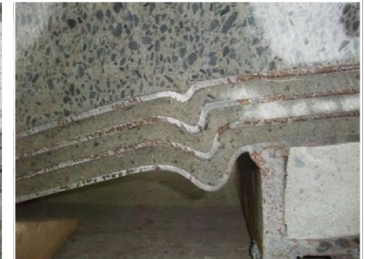
圧縮縁はらみ出し状況
