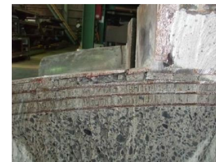
引張縁破断状況
