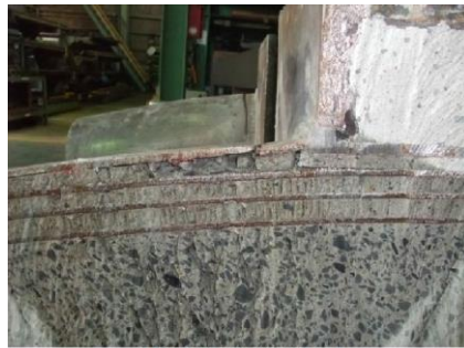
引張縁破断状況
