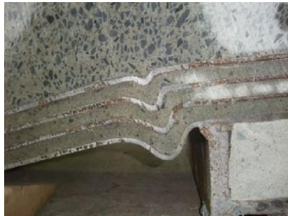
圧縮縁はらみ出し状況
