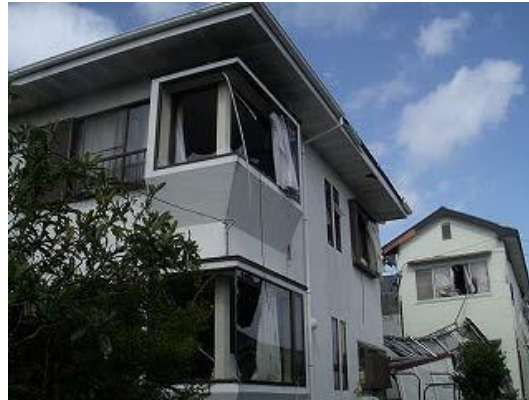
写真 30 出隅部の窓ガラスの被害
