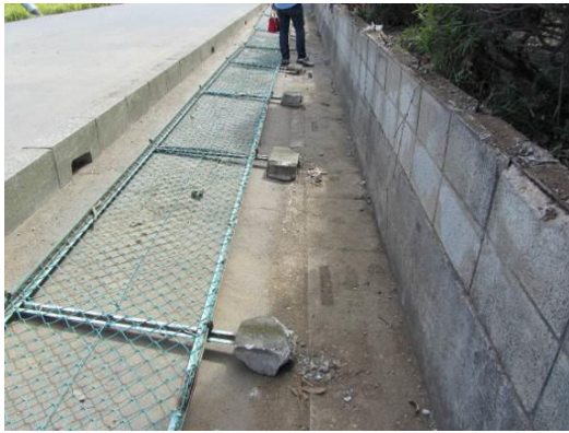
写真 4.1.9 フェンスの倒壊
