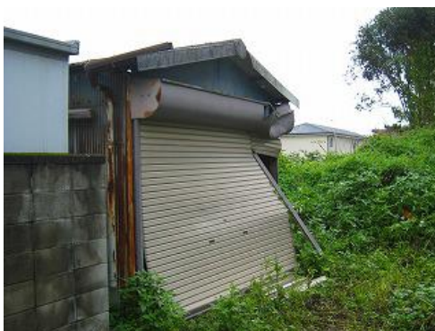
写真 22 シャッターの外れ
