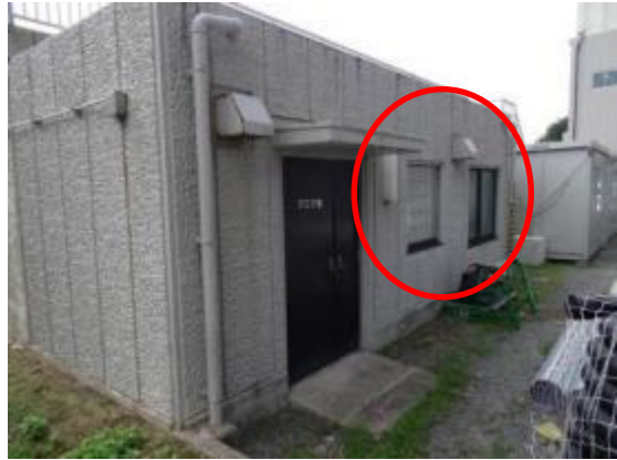
71 プロワ室ガラス窓
