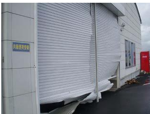
写真 10 シャッターの破損
