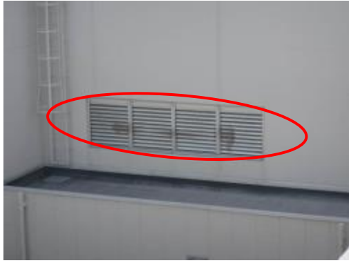
⑨ 中央制御室室外気取入ルーバ
