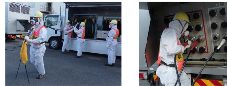
第1.0.13-4 図 放射線防護具類を着用した状態での電源車のケーブル敷設作業
